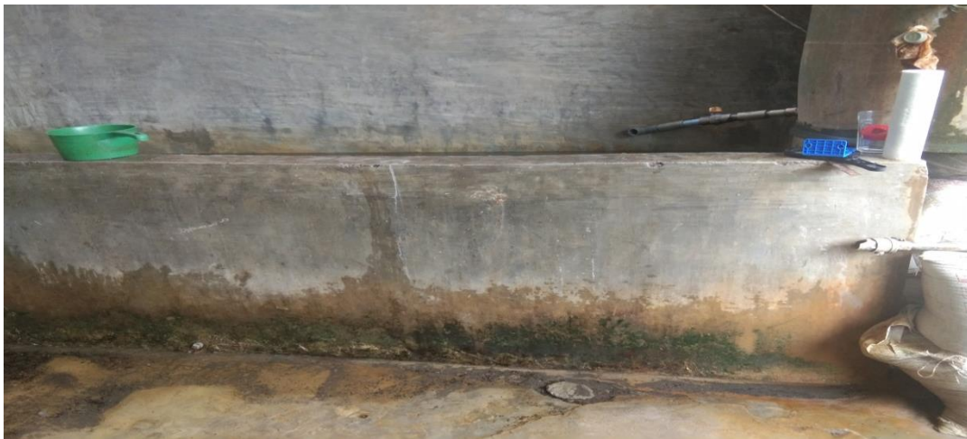
Gambar 1.2. Kondisi MCK yang memerlukan perbaikan
