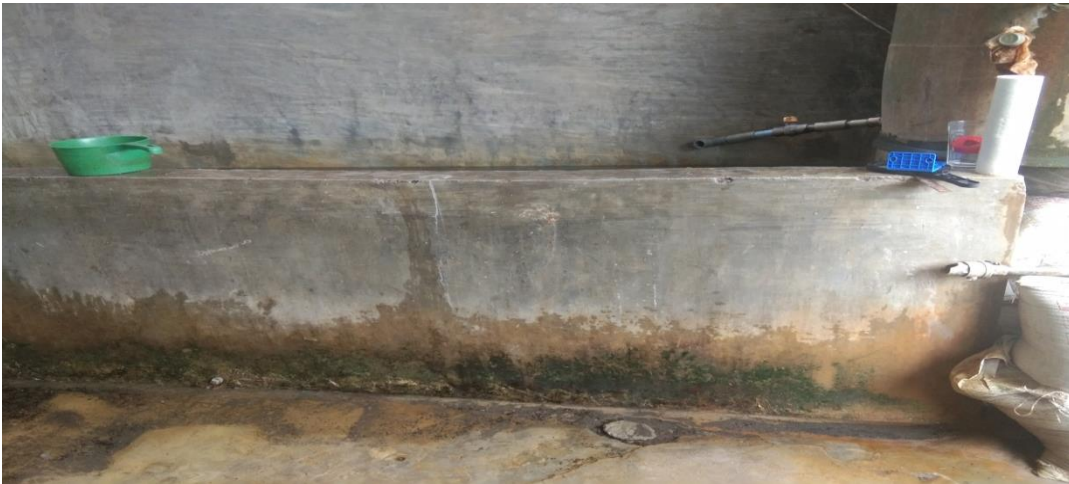
Gambar 1.2. Kondisi MCK yang memerlukan perbaikan
